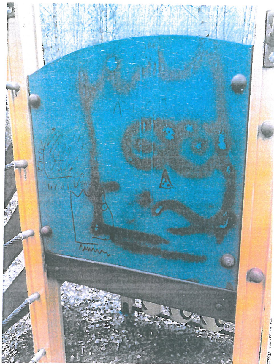
Załącznik nr 2 – Zdewastowane urządzenia na placu zabaw
